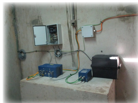
Instruments GeoSIG à la station de surveillance sismique du Barrage My Hassan 1er.
