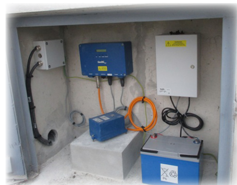
Instruments GeoSIG à la station de surveillance sismique du Barrage de Dar Khrofa.
